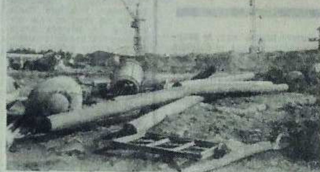
Taki bałagan pozostawił po sobie rzeszowski Instal.
