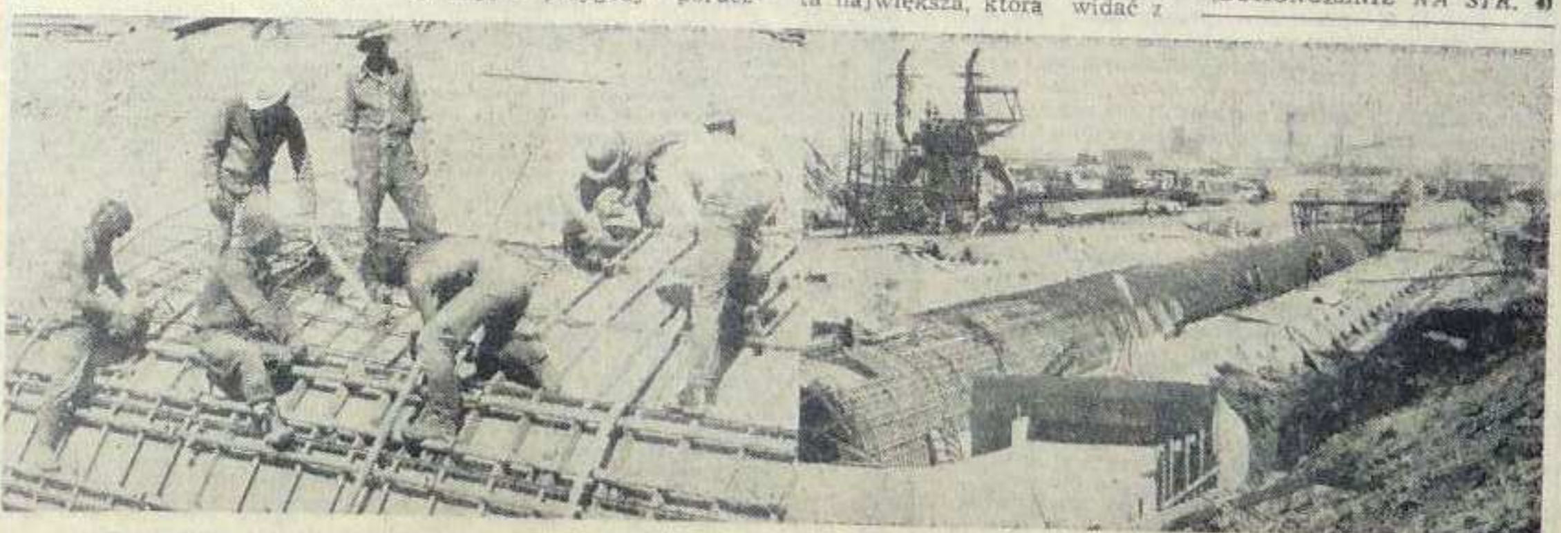
Brygada Ryszarda Zmarzlika z PBMPK Wrocław podczas zbrojenia żelbetonowej skorupy drugiego tunelu aglomerowni.
