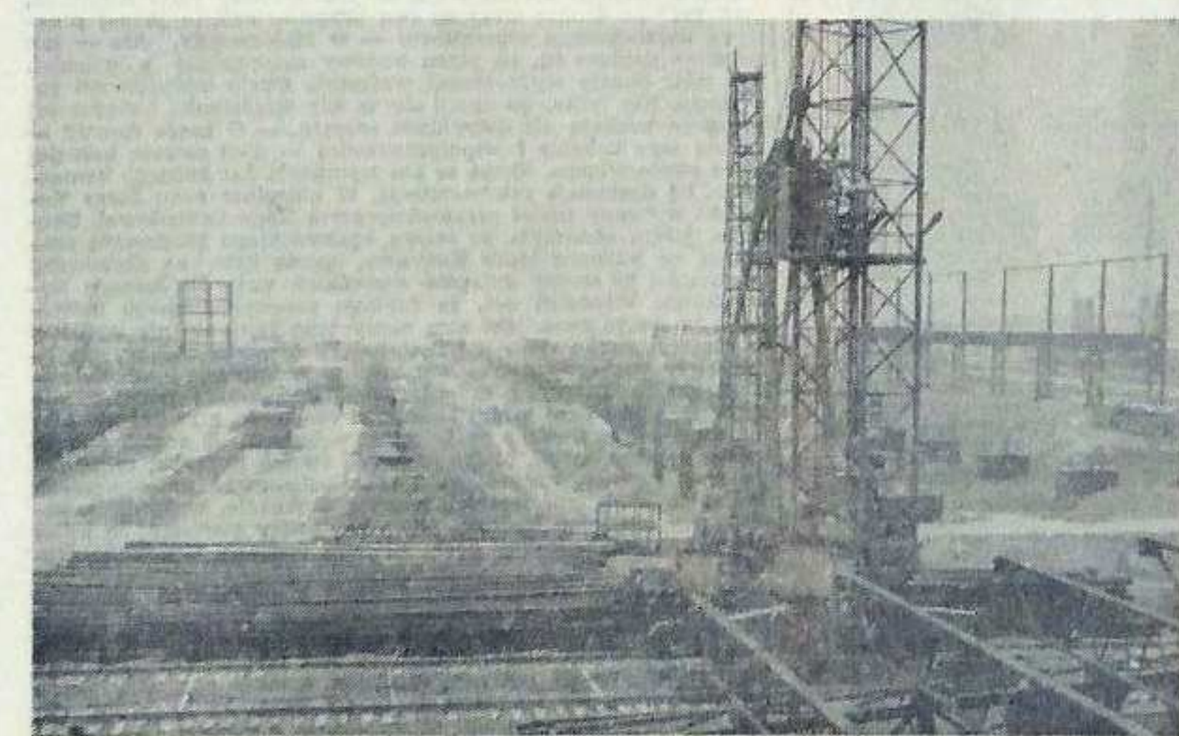
Zaproszenie do tańca. Fronty robót czekają na wykonawców. Na pierwszym planie namioty placu montażu połączonych dachowych.
