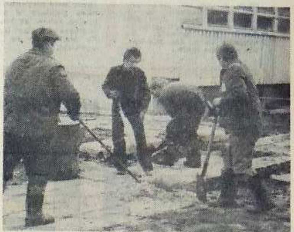
Wokół budynków i innych obiektów Huty wykonywano prace porządkowe. Na zdjęciu: młodzież z Centralnego Laboratorium.
