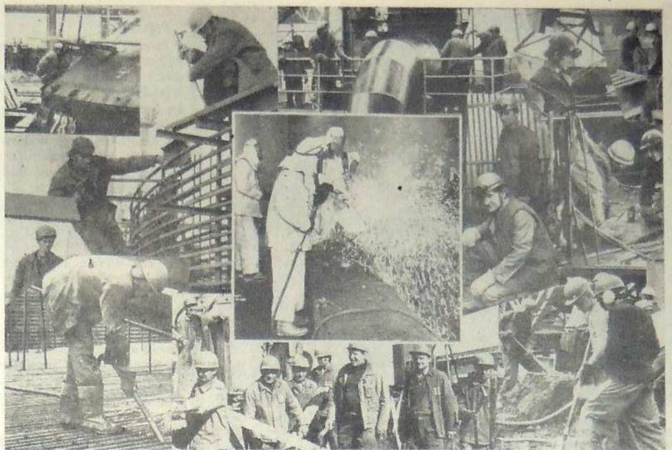
PRACOWITY rok 1977 kończy się pięknym akordem. Dzięki pracy ponad sześć tysięcy budowniczych, wielki piec nr 2 jest gotowy. Kolejny ważny etap mozolnej pracy i bezprzykładnej ofiarności ludzi z Budostalu-1, Mostostalu Kraków, Montochemu, Piecbudu, Instalu, Elektromontażu oraz kilkunastu innych przedsiębiorstw został uwieńczony wielkim zwycięstwem. Każdy z tych kilku tysięcy robotników może być dumny, że uczestniczył w tej szlachetnej walce o przedterminowe oddanie gospodarce narodowej tak ważnej dla kraju inwestycji.
