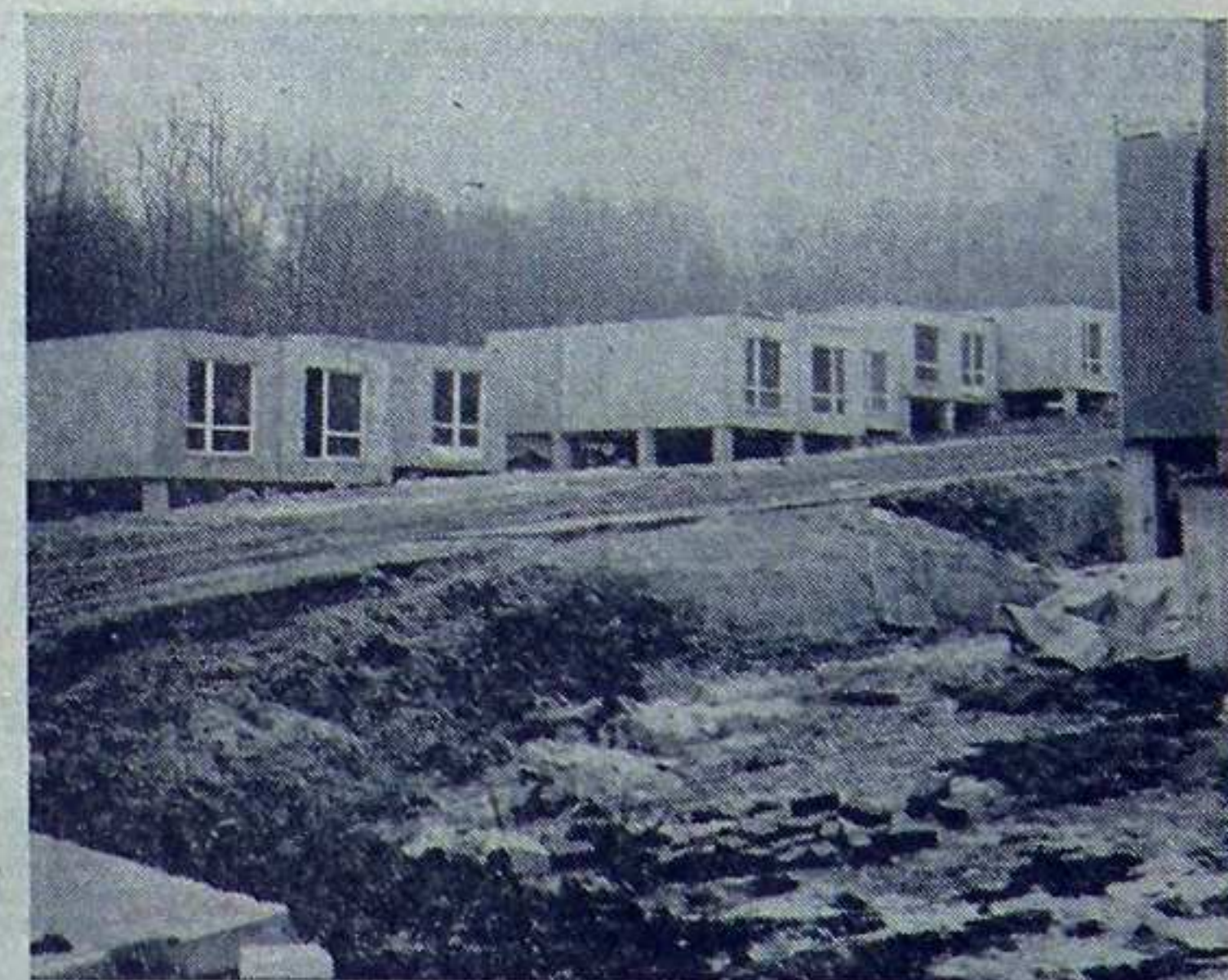
Już teraz, choć domki są jeszcze w stanie surowym, efektownie prezentuje się ten zespół obiektów wypoczynkowych w Rogoźniku. Zdj. P. Wąsikowski
