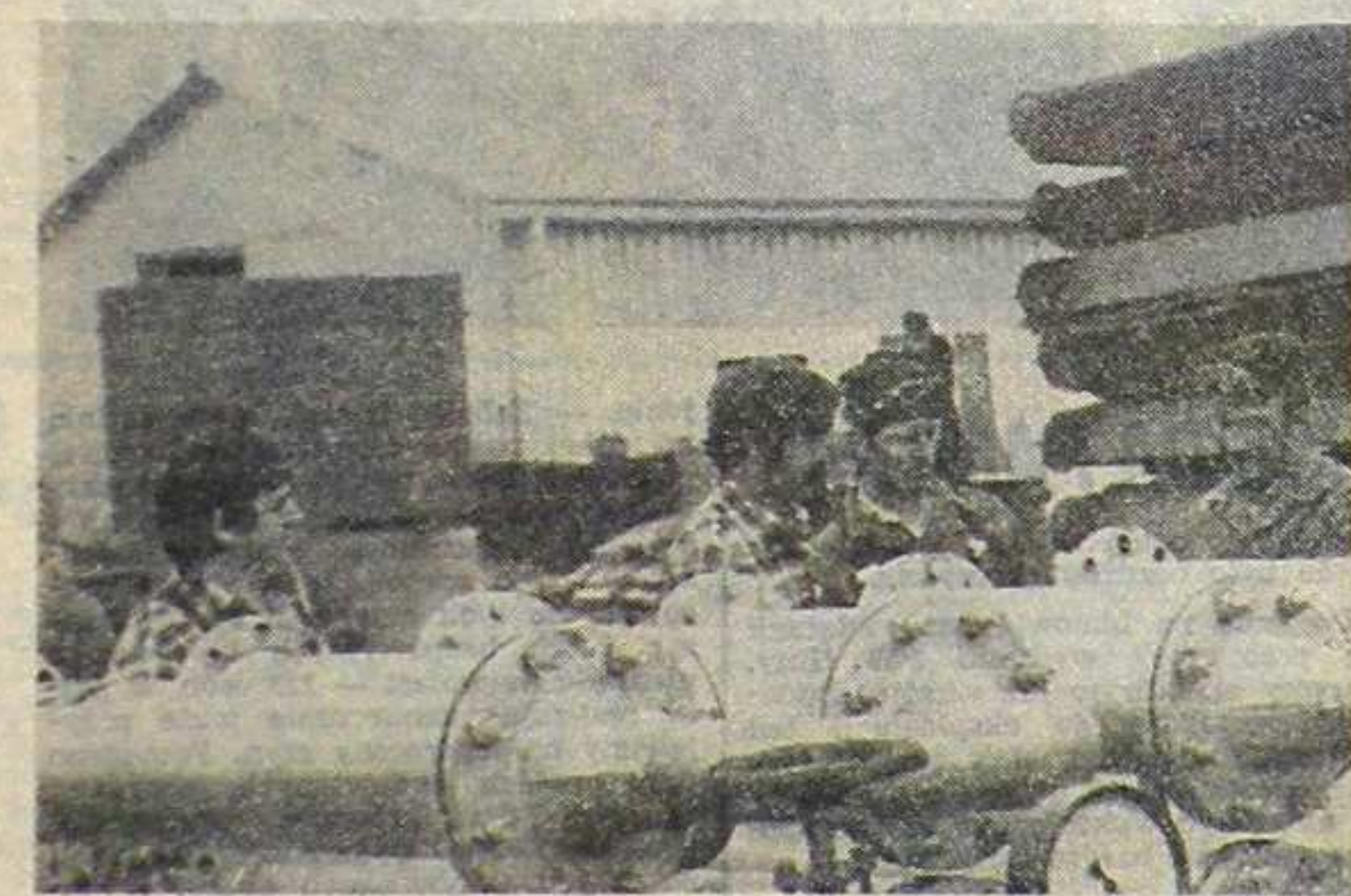
Przy sprawdzaniu szczelności baterii wymiennika ciepła zastaliśmy brygadę Jana Adamczyka. Poszczególne elementy baterii trafiają tu z Instalu Nasielski chyba bez kontroli technicznej. Jako że wężownice i „plaszcz” po napełnieniu wodą nie utrzymują przewidzianego dla próby ciśnienia. Trzeba więc za innych zaspawać nieszczelne spoiny. Od lewej stoją: brygadziści Jan Adamczyk, spawacz Andrzej Cieplich i dwaj najlepsi w brygadzie spawacze — Czesław Chmielewski i Michał Gmyrek.
