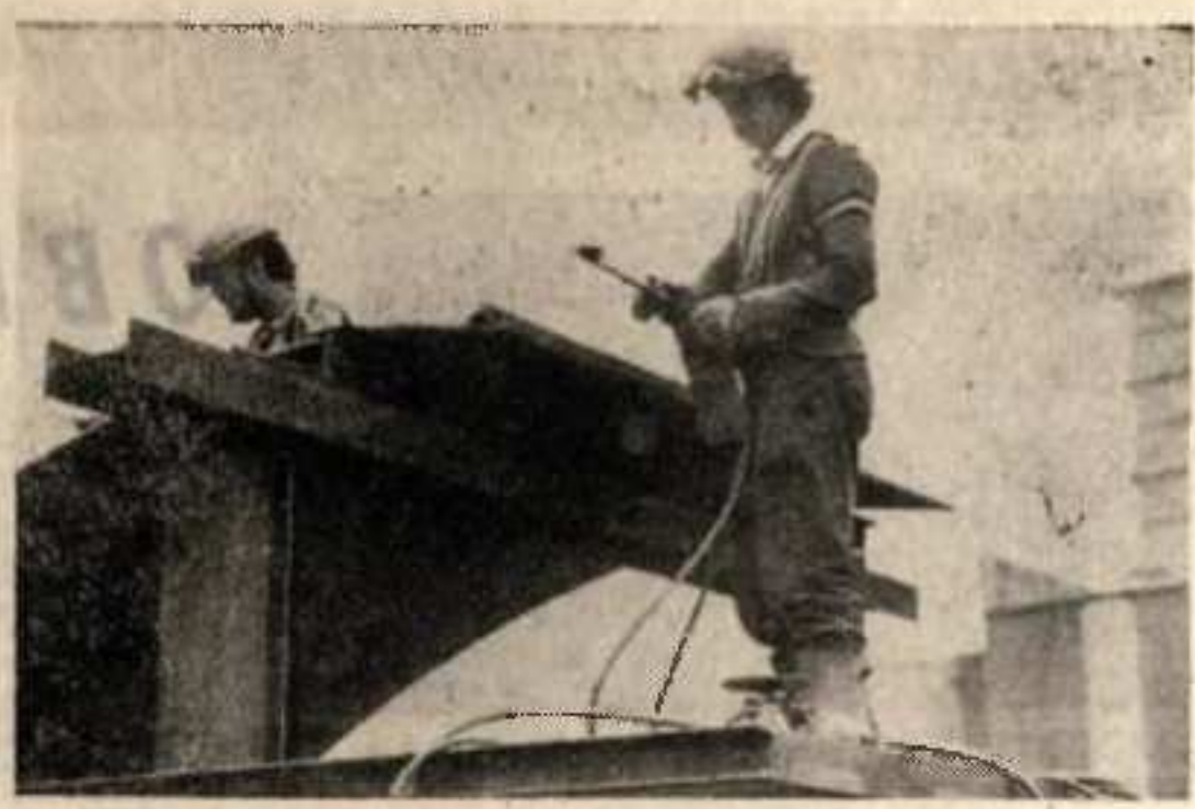
Pracownicy Zakładu Kraków przygotowują elementy niezbędne do remontu Wielkiego Pieca nr 1. Marek Szóstakowski
